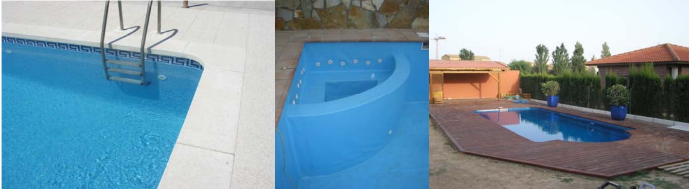
Detalle piscina de hormigón, piedra de coronación y playa
